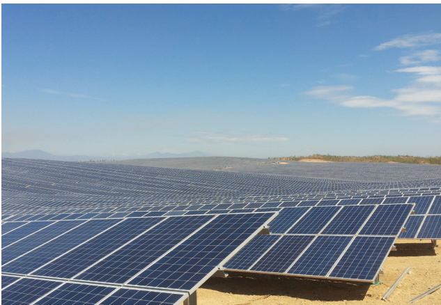
โรงไฟฟ้าพลังงานแสงอาทิตย์ เมืองมินญู ประเทศเมียนมาร์
